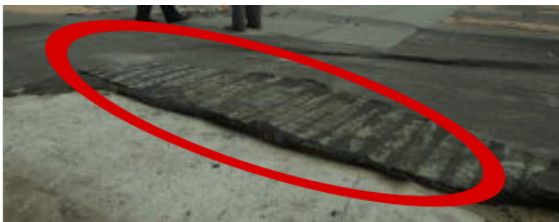
图1 H项目防水卷材使用不到位的实景图
