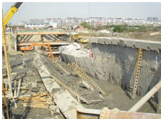
图1 钢支撑与地下连续墙预埋件没有有效连接出现边坡滑移
