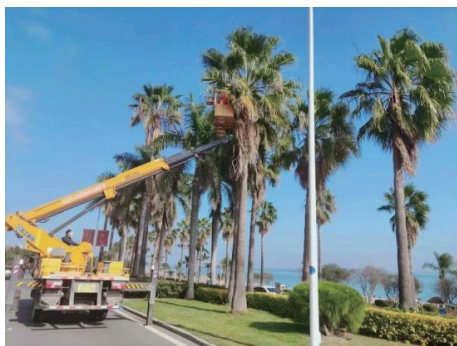
图一 城市景观工程施工高空风险
